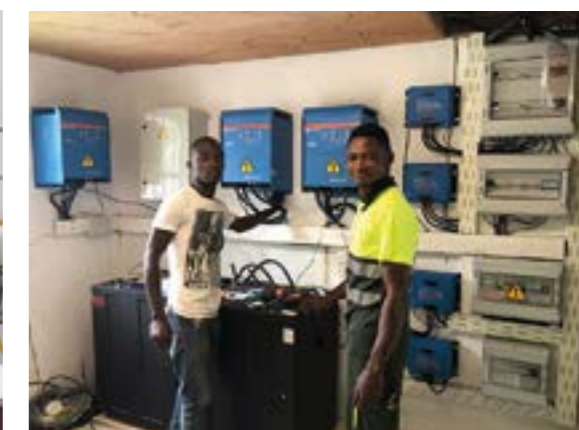
Brasken con su compañero en la sala de baterías del sistema solar
